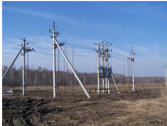
Рис. 2. Пример установки ВДТ в линии 10(6) кВ
